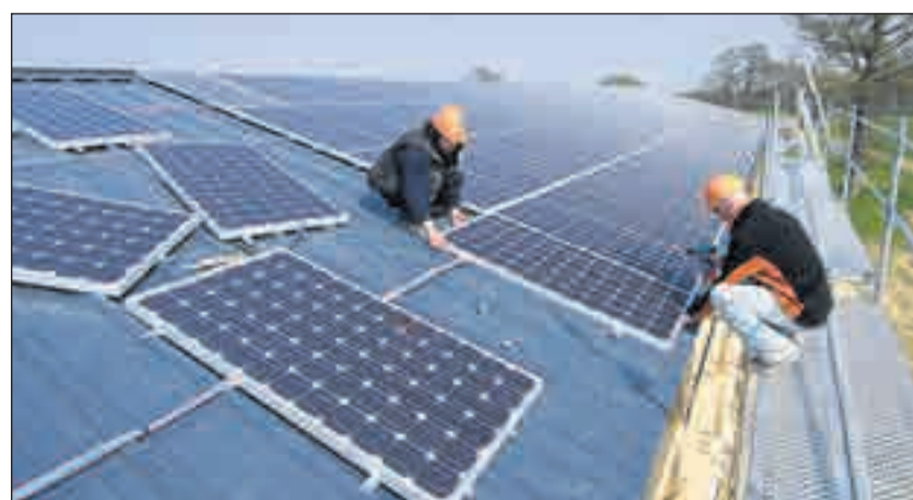
Apex Energies va ainsi construire et rénover six hangars agricoles. Ces six centrales seront capables de produire 600 kWc par an, l'équivalent de la consommation annuelle de 160 foyers environ.
